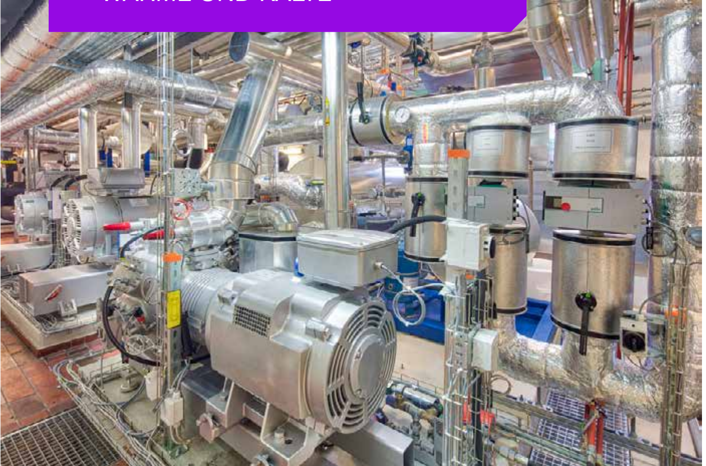
Kompressoren der neuen Kälteanlage in der Technikzentrale Kunsteisbahn Eglisee. Die Anlage arbeitet mit einem Zweikreissystem mit einem Wasser-Glykol-Solebetrieb und ist mit einer Wärmerückgewinnung ausgestattet, vgl. S. 21. Foto: Alex Käslin
